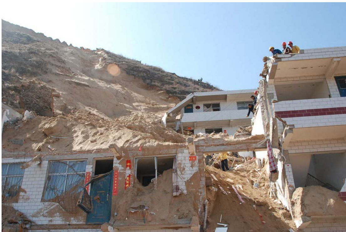
照片 2 陕西省子洲县双湖峪镇石沟村黄土崩塌摧毁房屋
